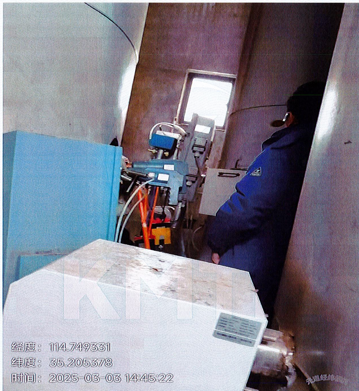
图 2-1 有组织检测 2#焚烧废气排放口 DA002
