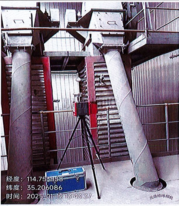
图 2-2 无组织检测 飞灰仓顶除尘风机 2 出口
